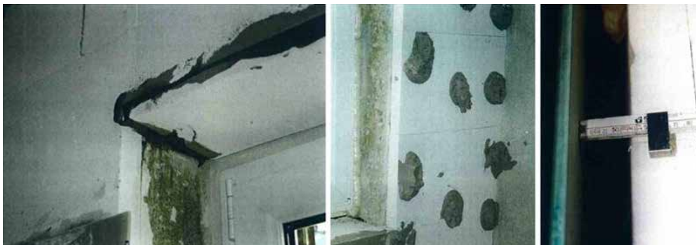
2. ábra Az 1998. évi felújítási munkákról készült felvételek, a referenciaanyag része: Fal- és ablakmélyedés-szigetelés (balra), vakolatcsomók a gipszkartonlapok rögzítéséhez és besüllyesztéséhez (középen) és a gipszkarton-burkolat távolsága a belső hőszigeteléstől (jobbra).
